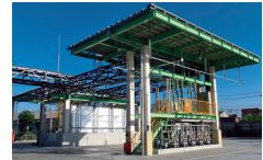
混合エマルジョン化施設
